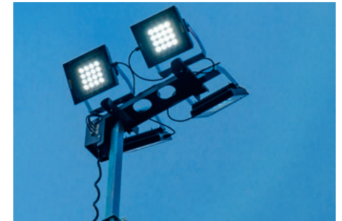
Lichtmasten mit LED-Technik und Generator
